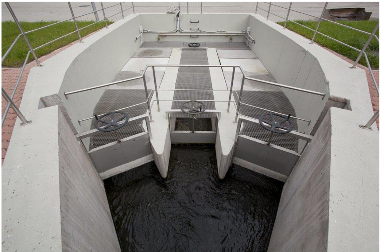
Obr. 3 ČOV Moravská Třebová – žlabový RO s návodními pilíři [6]
