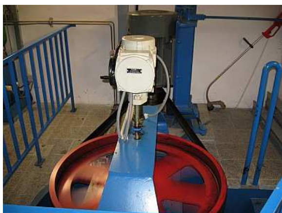
Obr.16 Elektrický servomotor, který ovládá natočení oběžných lopat
