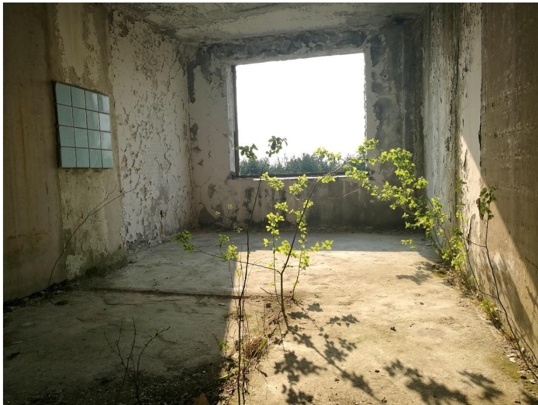
Příloha 5: Vykradené a zdevastované byty v Ploužnici (Pípal 2018).
