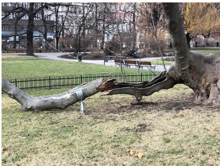
Obr. č. 7 podpěra větve na Karlově náměstí v Praze. Je vidět i část nízkého plotu, který snižuje pohyb v okolí stromu (autorka 2022)
