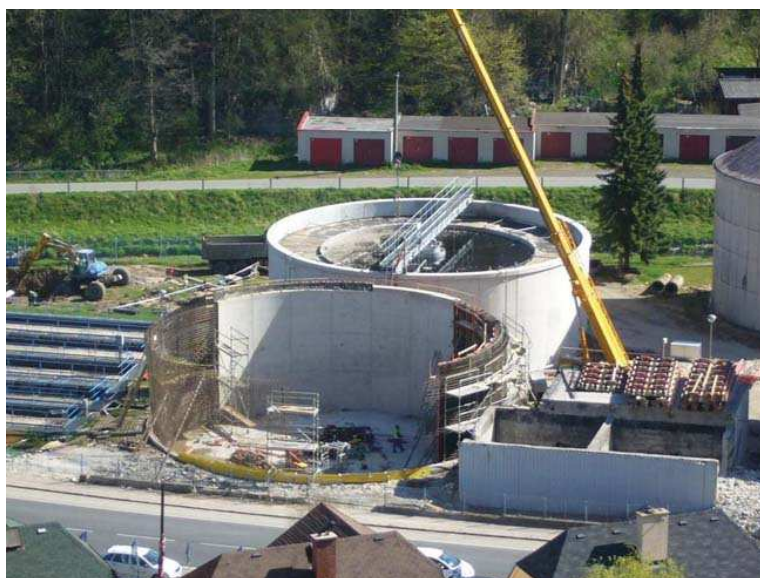
Obrázek 4-1 Rekonstrukce ČOV Česká Třebová, dokončena v roce 2013 [21]
