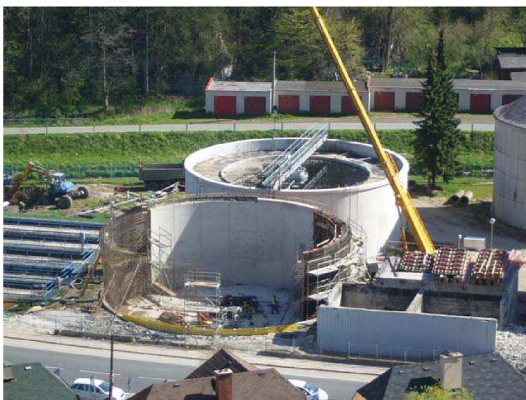
Obrázek 4-1 Rekonstrukce ČOV Česká Třebová, dokončena v roce 2013 [21]
