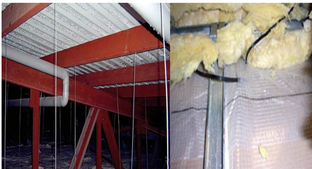
Obrázek 18 Kondenzace na spodní straně pláště vlivem porušené parotěsné vrstvy [31]
