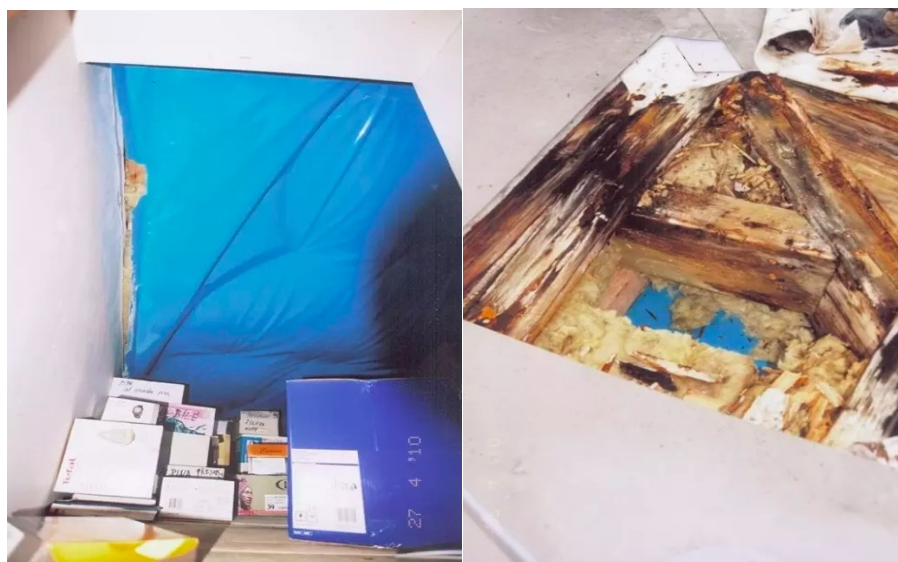
Obrázek 17 Špatné napojení parozábrany, následné poškození dřevěných prvků [30]
