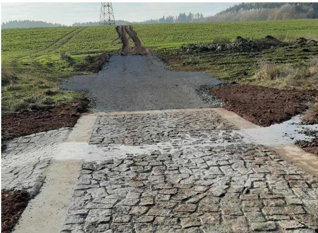
Obrázek 23: Polní cesta VPC 13, niveleta v místě brodu – úprava PD, rok realizace 2020 (NOVOTNÁ 2020)
