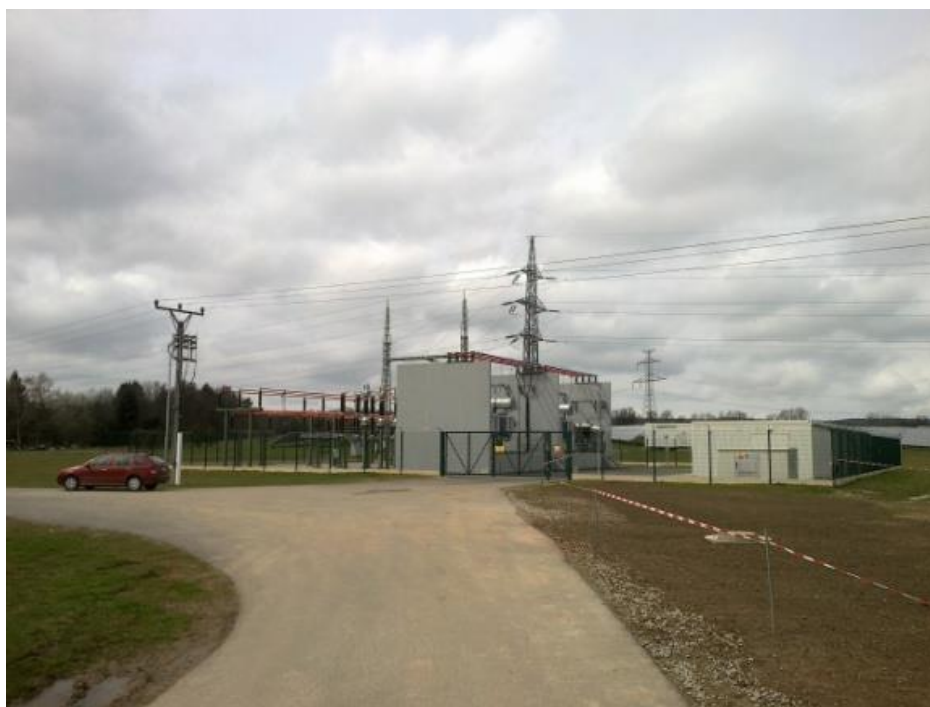
Obr. 12 Elektrorozvodna FV elektrárny Ševětín (západní blok) , autor Jan Trnobranský, 8. 4. 2012
