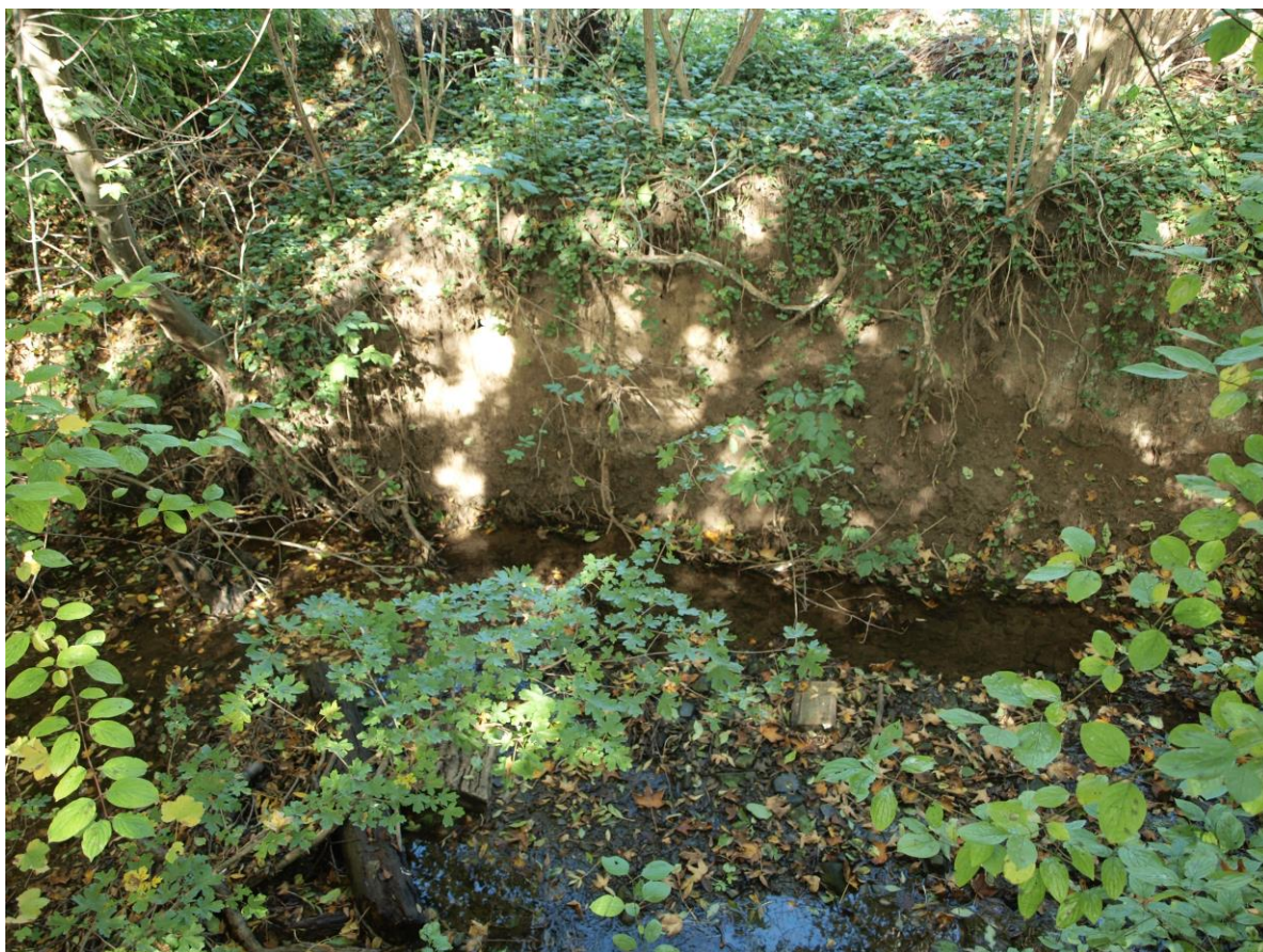
Fotografie č. 43 – koryto Břestického potoku poškozené erozí (Břestek)
