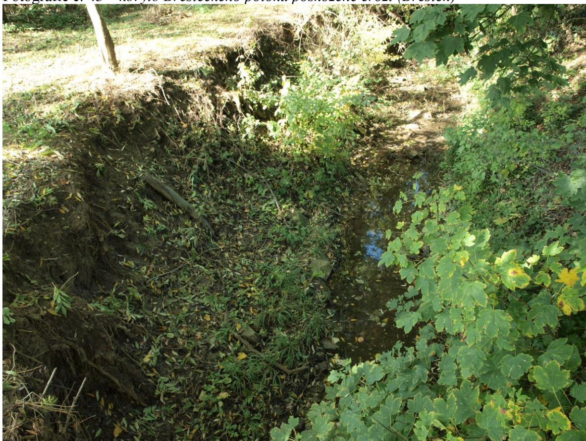
Fotografie č. 44 – koryto Břestického potoku poškozené erozí v další části (Břestek)
