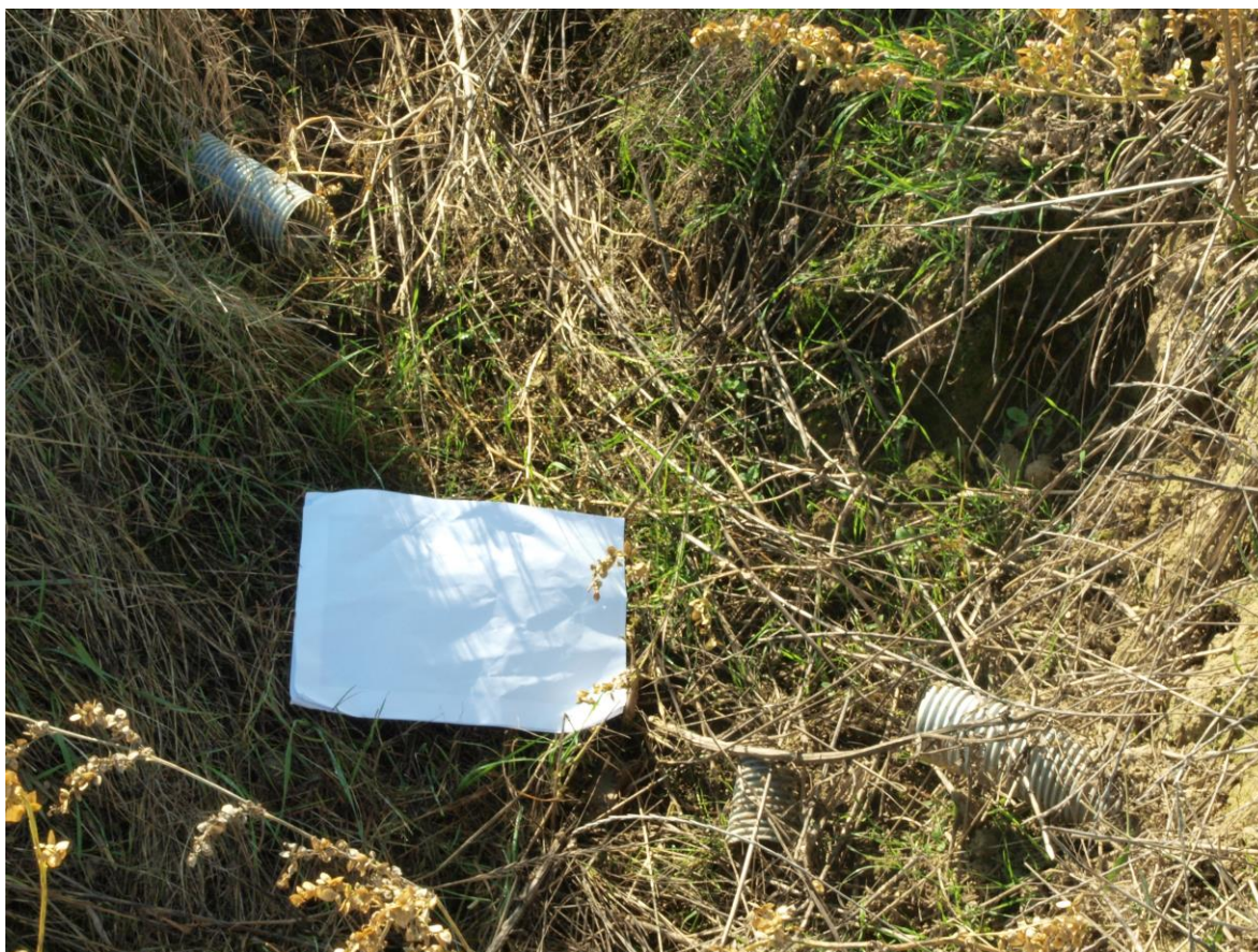
Fotografie č. 41 – porušená drenáž v erozní rýze, jako měřítko papír A4 (Břestek)
