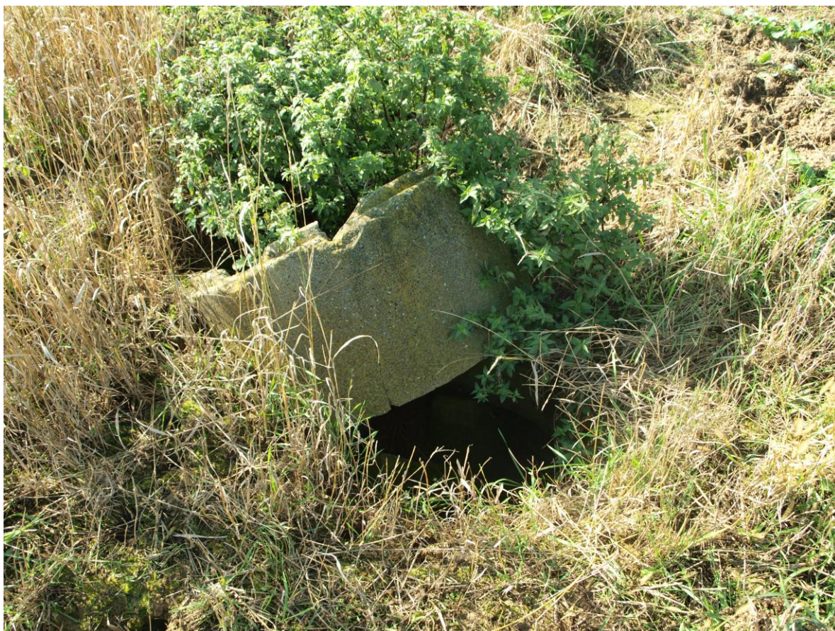
Fotografie č. 27 – poškozená druhá šachtice (Břestek)
