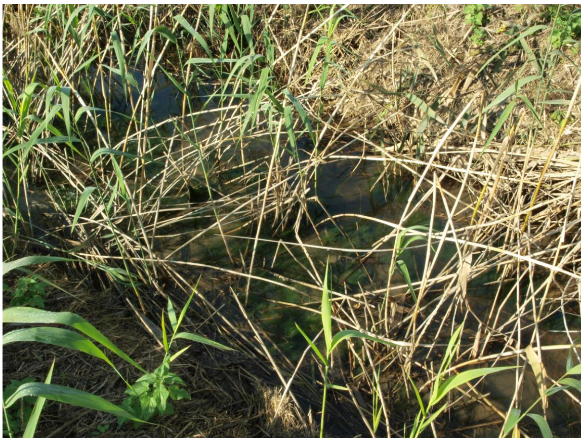
Fotografie č. 21 – zanesené koryto Polešovského Potoku
