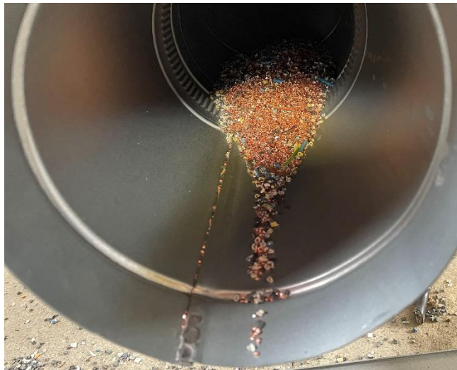
Obrázek 20: detail trubky pneumatického dopravníku. (autor, 2022)
