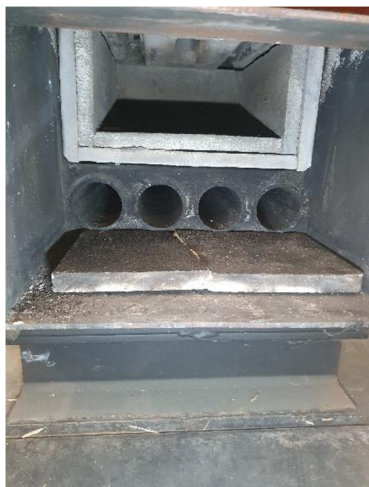
Obr. 29 Šamotové obloženie spaľovacej komory
