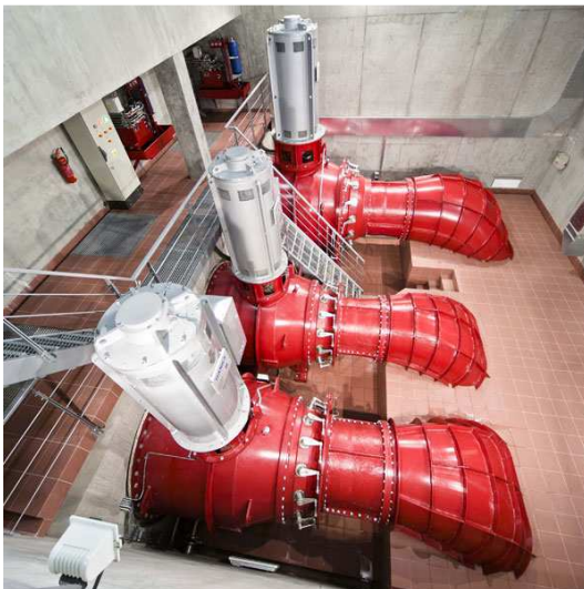
obr. 4 Malá vodní elektrárna
