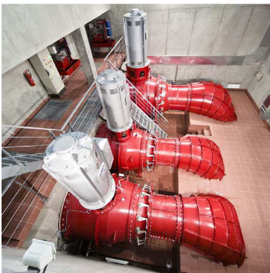
obr. 4 Malá vodní elektrárna
