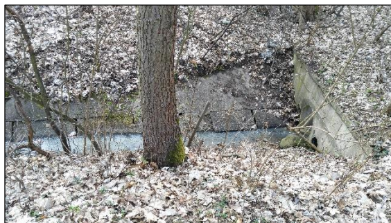
Obr. č. 51 – výtok odpadních vod do strouhy (Egerová, 2018)
