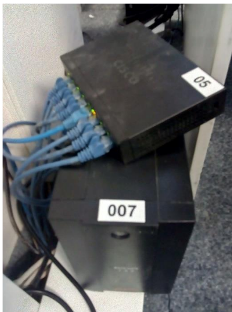
Obrázek 1.18: Přepínač komunikačního systému napájený přes záložní zdroj
