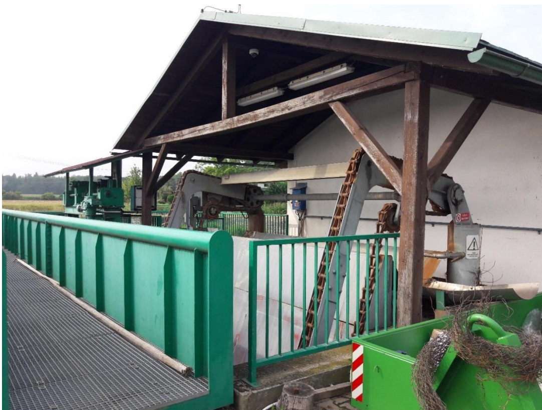
Obrázek 21: Čistící stroj MVE Počáply
