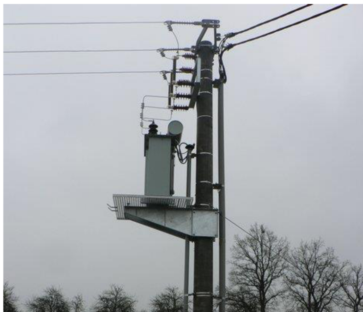
Obrázek P-3: Stožárová transformační stanice [28]
