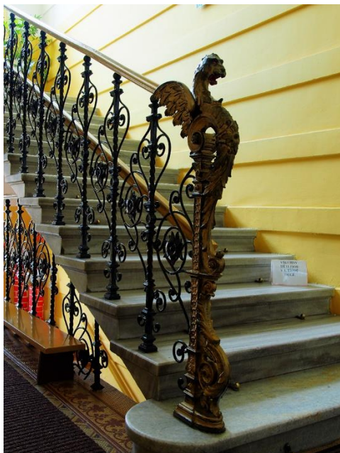
86. Eduard Frank, vila Floriana Schmidta jun., 1895, samonosné schodiště s dekorativním zábradlím, současný stav.
