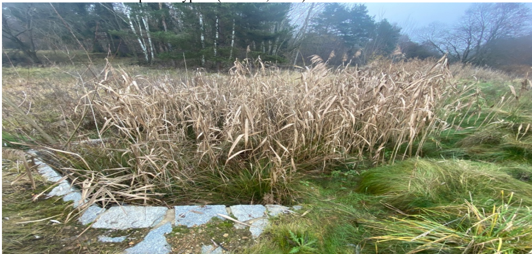
Obr. 39: Neudržovaná spodní výpust (Kočová, 2022)
