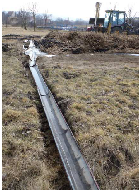
Obr. 5: Odtokový žlab pro odvod vody.
