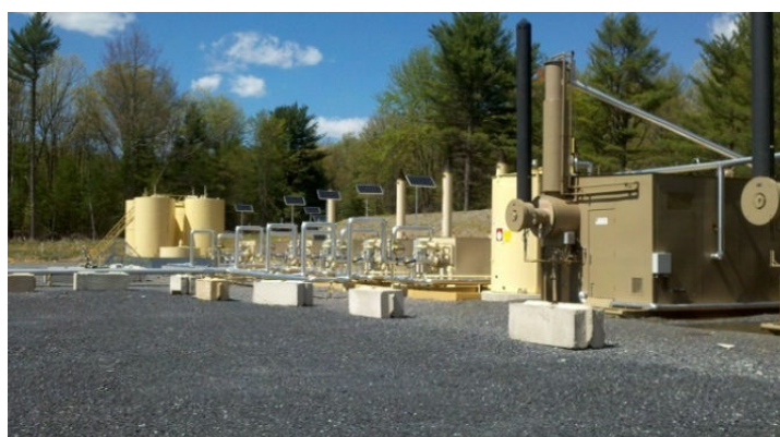
Zařízení na oddělení produkované vody a nádrže na její dočasné uskladnění [56]
