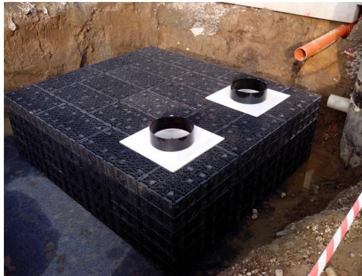
Obr. 5.2 - RN složená z 60 ks tzv. rain bloků (OC v Otrokovicích) [14]
