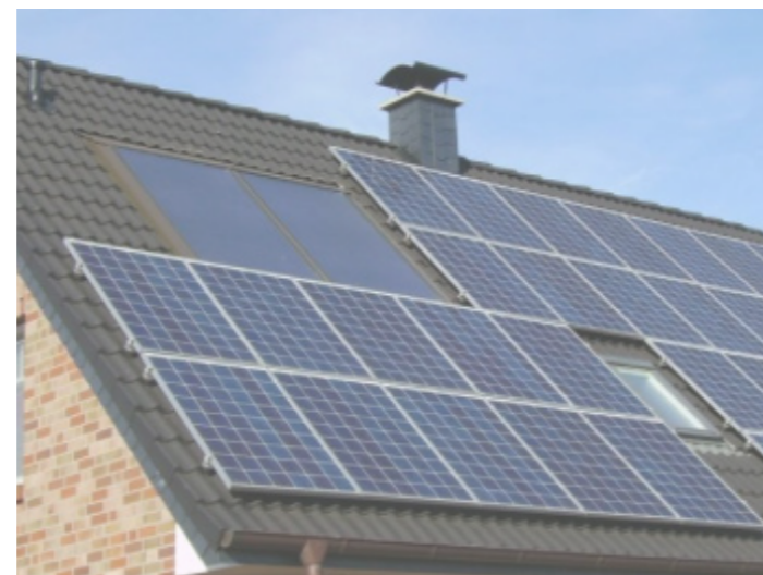
Obrázek č. 72: Solární panely na střeše domu (Arpeg, 2022)
