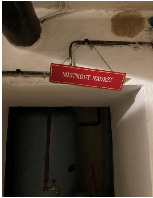
Obrázek 21. Místnost nádrží (zdroj: vlastní)
