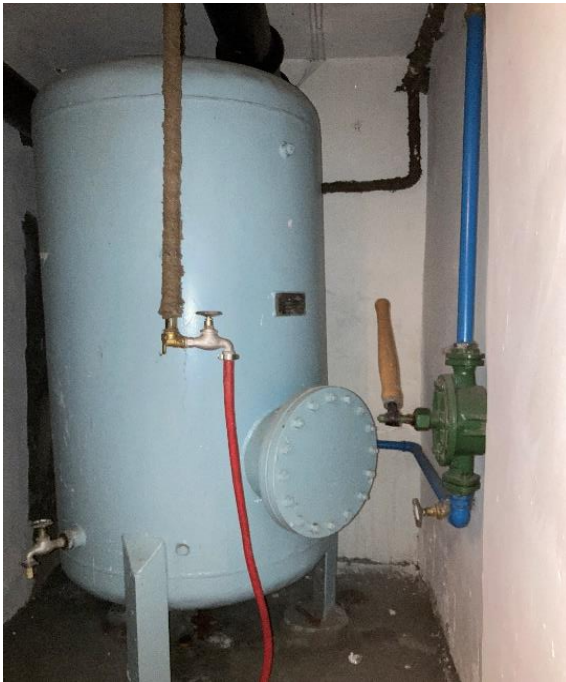
Obrázek 20. Boiler na vodu (zdroj: vlastní)
