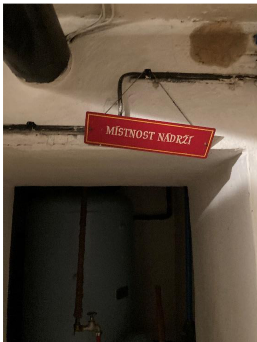
Obrázek 21. Místnost nádrží (zdroj: vlastní)
