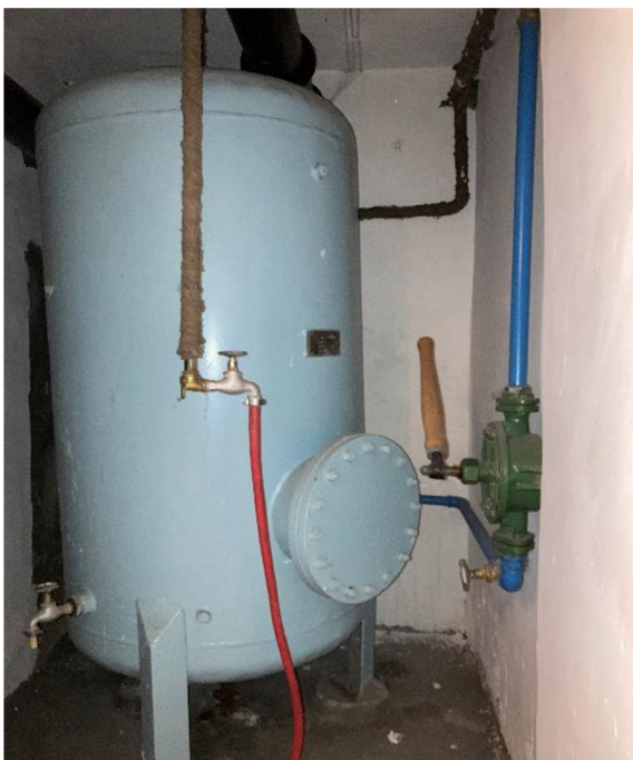
Obrázek 20. Boiler na vodu (zdroj: vlastní)
