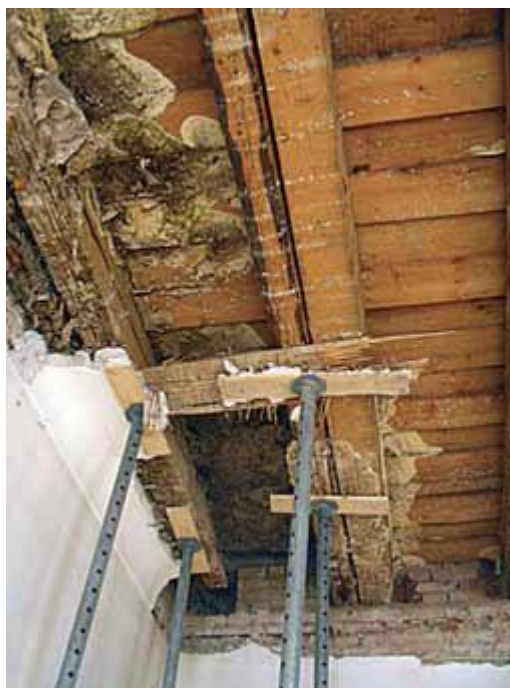
Obrázek 4. Fotografie dřevokazné houby na dřevěném stropu 5
