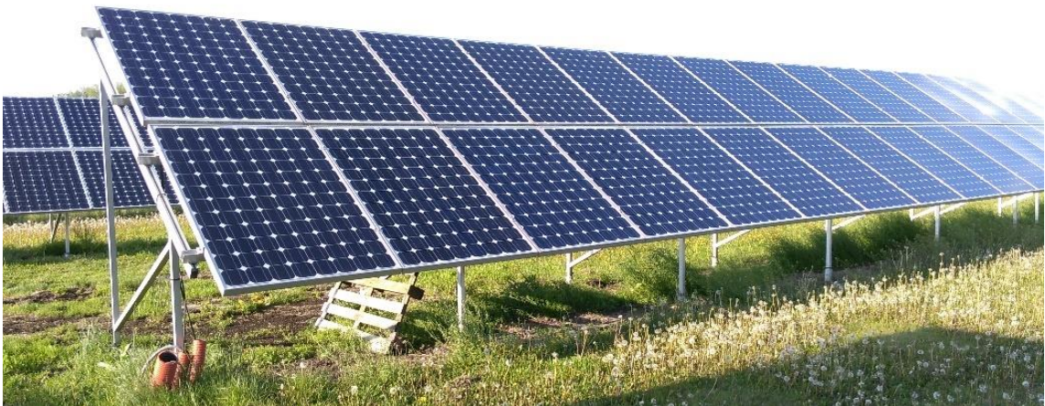
Příloha 4: Monokrystalické solární panely použité v FVE Kostice (zdroj: vlastní fotografie)
