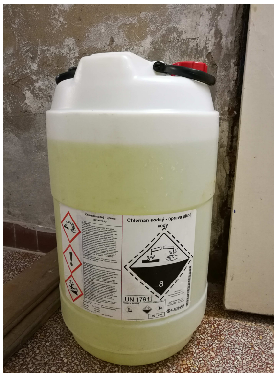
Obrázek 7 Chlornan sodný sloužící k úpravě pitné vody na vodojemu v Kateřiních
