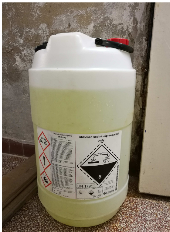
Obrázek 7 Chlornan sodný sloužící k úpravě pitné vody na vodojemu v Kateřinách
