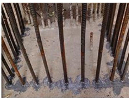
Obr. 17: Betonářské výztuže zakotvené do podkladní betonové desky pomocí rychle tvrdnoucí epoxidové chemické kotvy [19]
