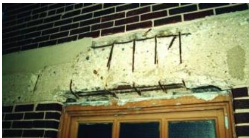
Obr. 5: Degradace betonu s malou tloušťkou krytí způsobena převážně vlivem karbonatce [1]
