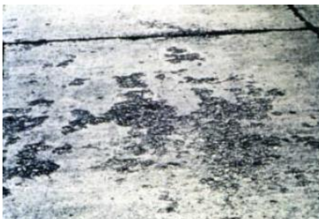
Obr. 7: Odlupování povrchu betonové dlažby vlivem mrazového narušení [1]
