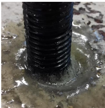
Obr. 108: Minimální povytažení kotvené závitové tyče v kotvicí hmotě EP-K 70% OS (vznik pórů v kotvicí hmotě u paty závitové tyče)
