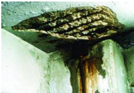
Obr. 1: Koroze výztužné oceli – nejběžnější příčina degradace betonu [1]
