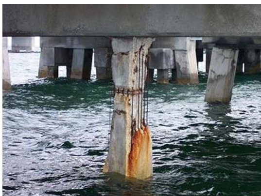
Obr. 3: Píliře mostu poškozené korozí výztužné oceli vlivem působení chloridů z mořské vody [2]
