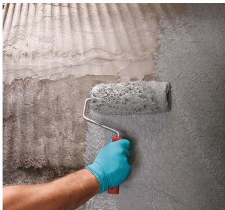
Obr. 9: Aplikace hydroizolační cementové ochranné hmoty při izolaci betonové budovy po úrovni terénu [9]
