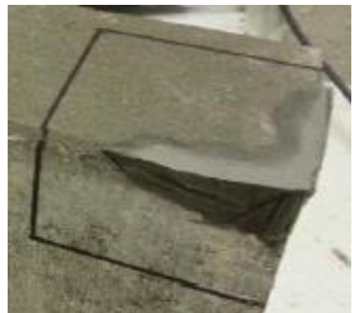
Obr. 172: Reprofilovaná část obrubníku (po působení povětrnostních vlivů), která byla vyříznuta a následně snímaná pomocí CT Tomografie (hmota EP-S 60% KP-TŘ)
