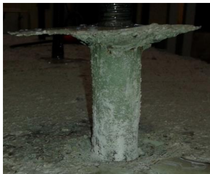
Obr. 109: Nadměrné povytažení kotvené závitové tyče současně s kotvicí hmotou EP-K2
