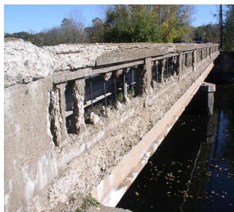
Obr. 8: Betonový most vykazující silné poškození mrazovým narušením [6]
