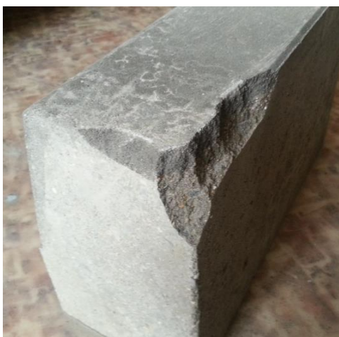
Obr. 121: Uražený roh betonového silničního obrubníku
