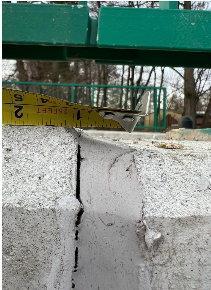
Obr. 41 - narušené těsnění dilatační spáry
