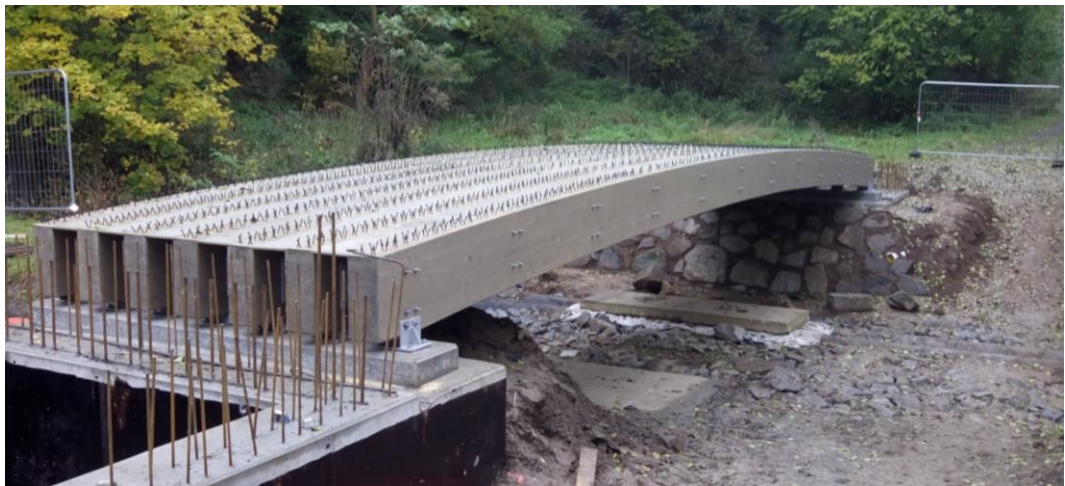
Obr. 20 - lávka v Benešově před sprážením dřevěných trámů s betonovou deskou. (zdroj: https://www.casopisstavebnictvi.cz/clanky-prvni-sprazene-drevobetonove-lavky-v-cr.html )
