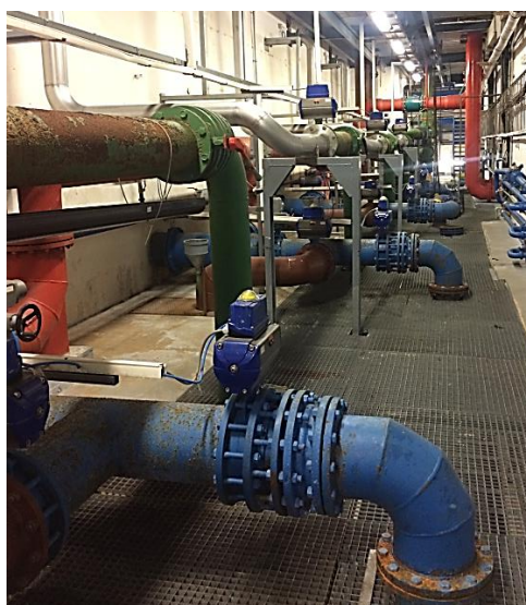
Příloha obr. 8 - Soustavu potrubí vedoucích k rychlofiltrům Zdroj: BRIXOVÁ; 2017 ( soukromý fotoarchiv )
