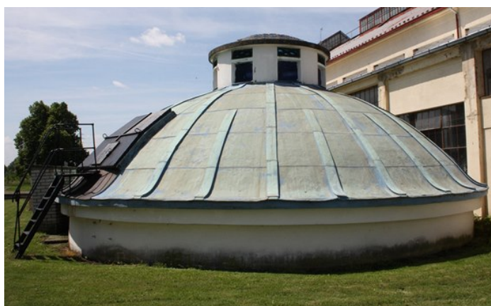
Příloha obr. 2 - Hlavní zásobní jímka vody v objektu Káranské vodárny Zdroj: www.metro.cz
