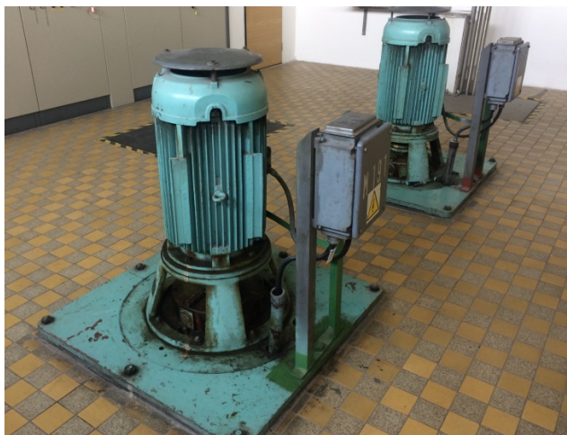
Příloha obr. 7 - Čerpadla pro čištění rychlofiltrů Zdroj: BRIXOVÁ; 2017 ( soukromý fotoarchiv )
