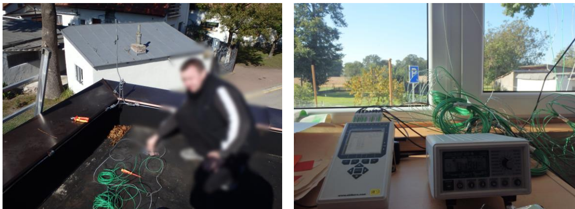
Obr. 33 Aplikace měřících čidel, pohled na měřící ústředny [autor]
