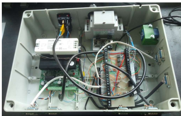
obr. 5-36 Komponenty elektrické skříně
