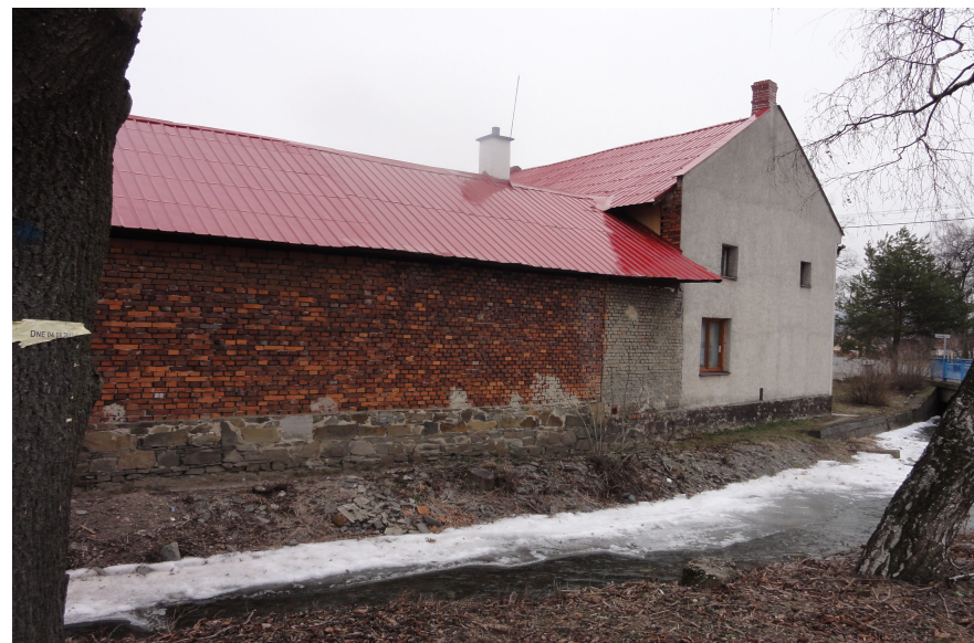
Foto 6. Jezernice: neefektivní opatření: „zpevňování“ břehu stavební suti (březen 2013)
