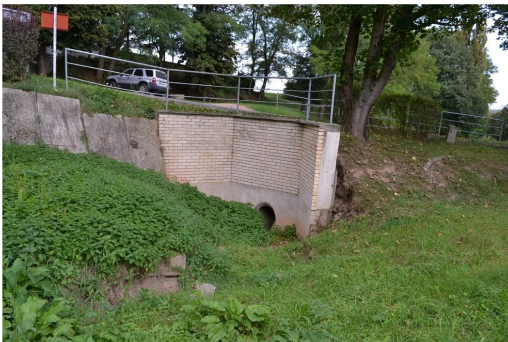
Příloha 18: Trubní propustek při ústí strže do intravilánu obce Lužná u Rakovníka – lokalita Lužná 1-B
