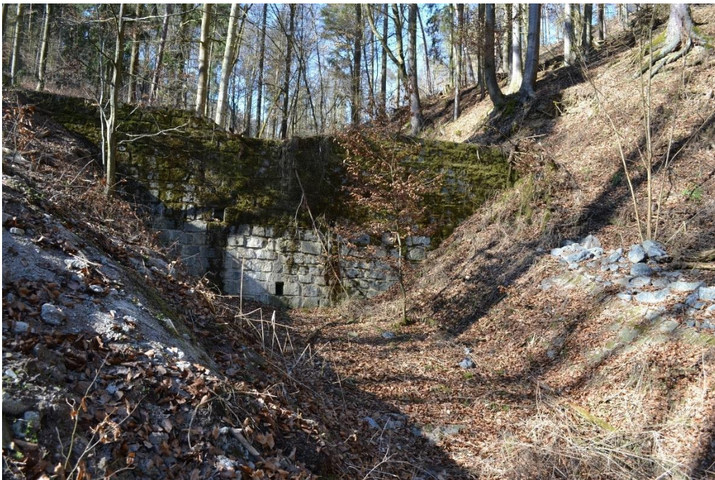
Příloha 26: Horní retenční kamenná přehrážka na lokalitě Pustověty 1. Výška v přepadové hraně 4, 2 m; šířka v přepadové hraně 2, 3 m; celková šířka 15 m.
