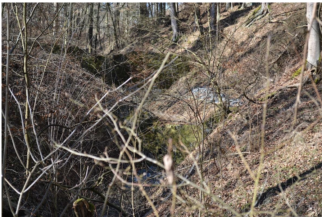
Příloha 27: Pohled na obě kamenné přehrážky na lokalitě Pustověty 1. Rozměry spodní přehrážky jsou: výška v přepadové hraně 2,6 m; šířka v přepadové hraně 2,4 m; celková šířka 9 m.
