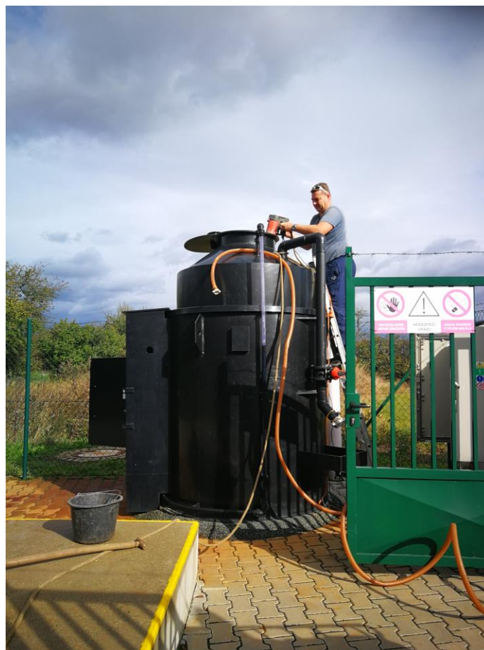
Obrázek 24 Odčerpání síranu železitého ze zásobní nádrže
