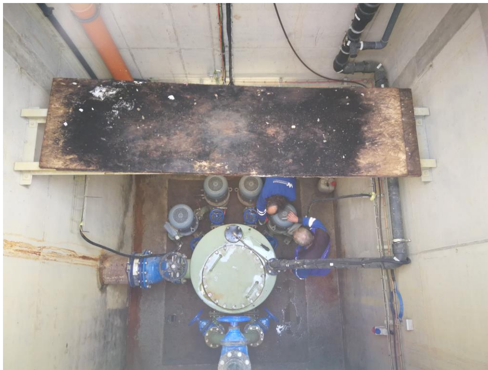
Obrázek 21 Čerpací stanice OV v Neslovicích
