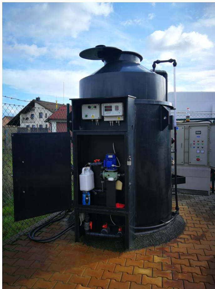
Obrázek 22 Dávkovací čerpadlo v Neslovicích
