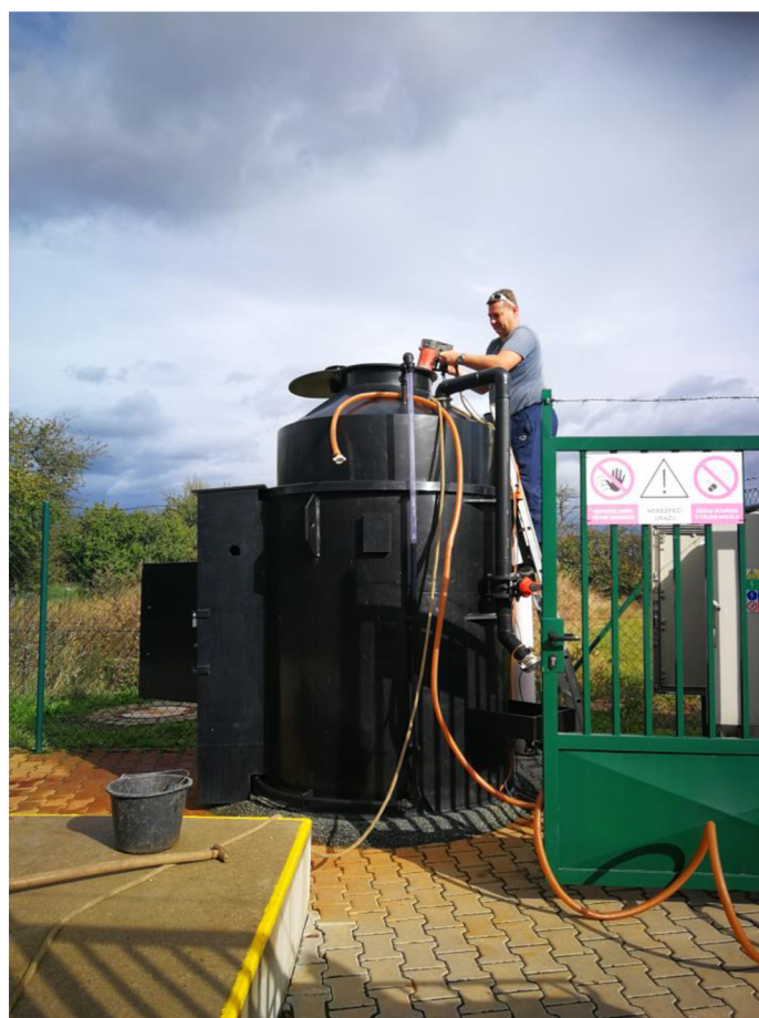
Obrázek 24 Odčerpání síranu železitého ze zásobní nádrže
