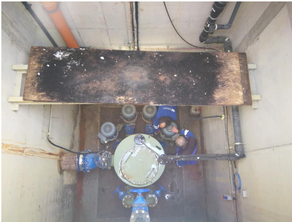
Obrázek 21 Čerpací stanice OV v Neslovicích
