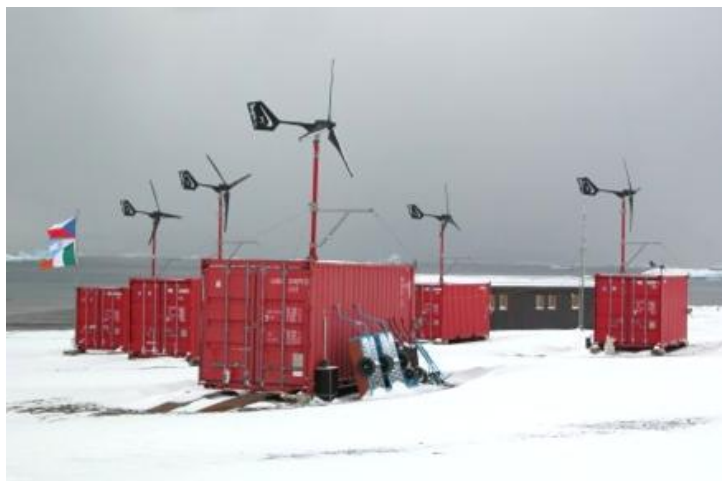
Obr. 4.13: Elektrárny zásobující českou polární stanicí v Antarktidě [55]
