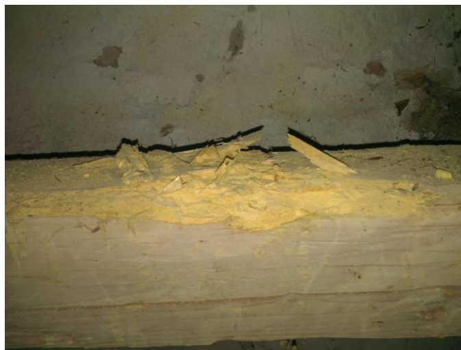
Obr. 47 Napadení kleštiny tesaříkem krovovým
