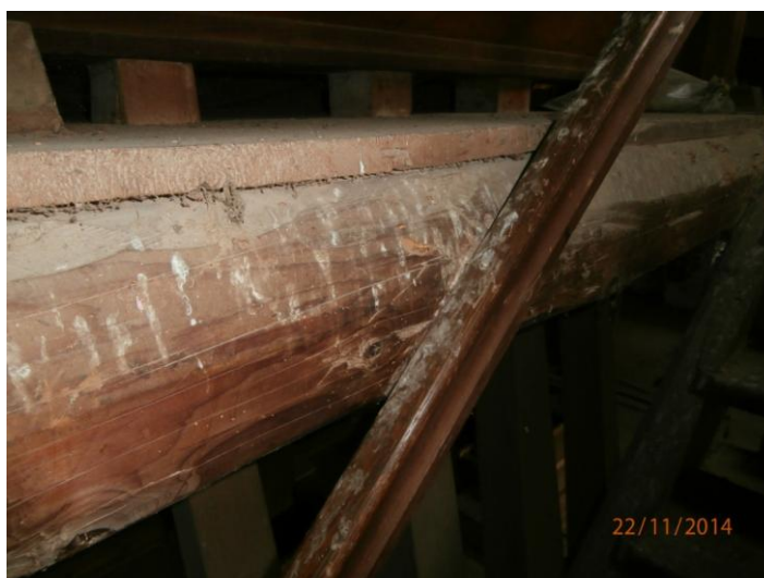
Obr. 52 Poškození povrchu prvků od ptactva
