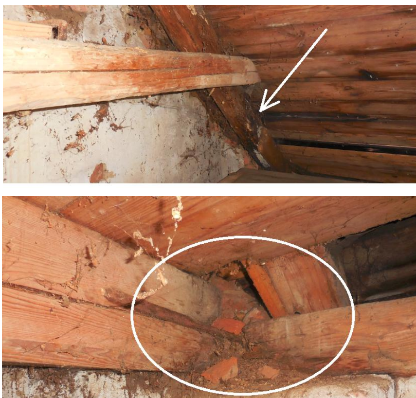
Obr. 34 Degradace dřeva hnilobou (nahore: poškození krokve vazby č. 19, dole: poškození při napojení stropního trámu s pozednicí)
