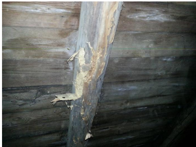
Obr. 46 Napadení krokve tesaříkem krovovým
