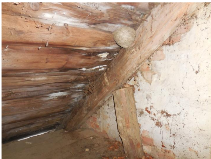
Obr. 50 Hniloba způsobená zatékající dešťovou vodou
