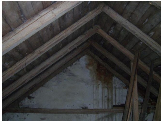
Obr. 45 Pohled na zatékání po ostění.
