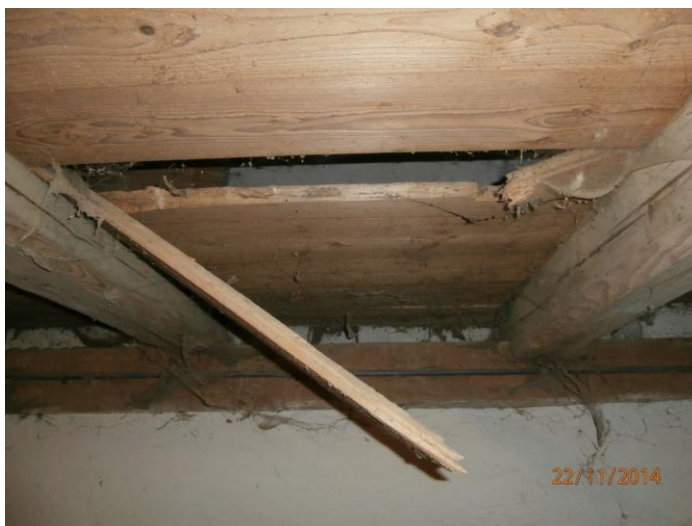
Obr. 49 Destrukce podlahové krytiny
