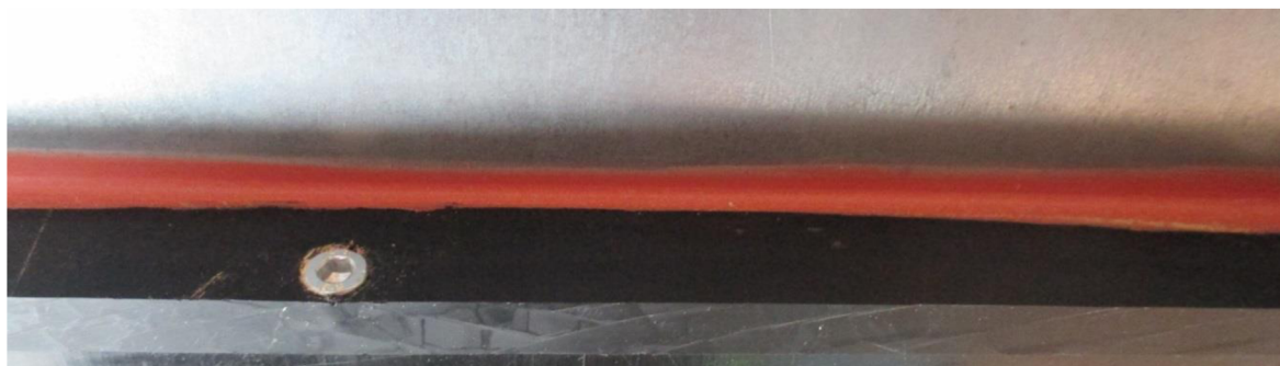
Obr. 3.8 Zatmelení rohu mezi podstavcem a vnějším pláštěm.
