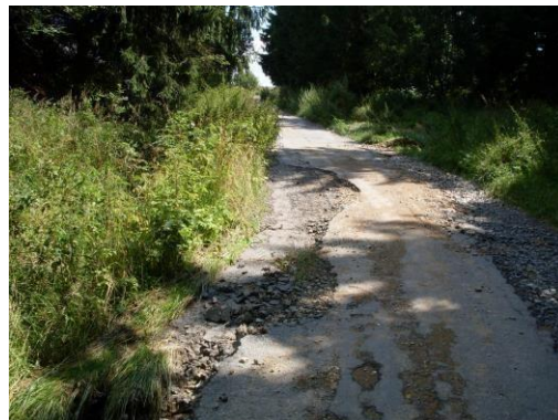
Foto č. 9 Poškozená komunikace v důsledku erozní události
