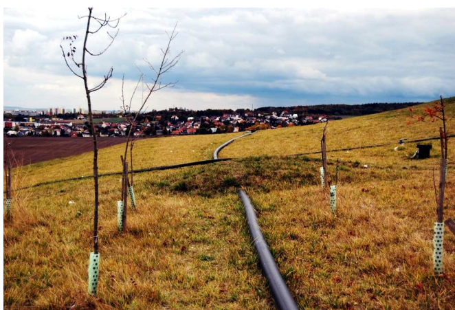
Foto 4.6 Potrubí odplyňovacího systému. Po rekultivaci je potrubí přemísťováno na povrch skládky. (Zdroj: Autor)
