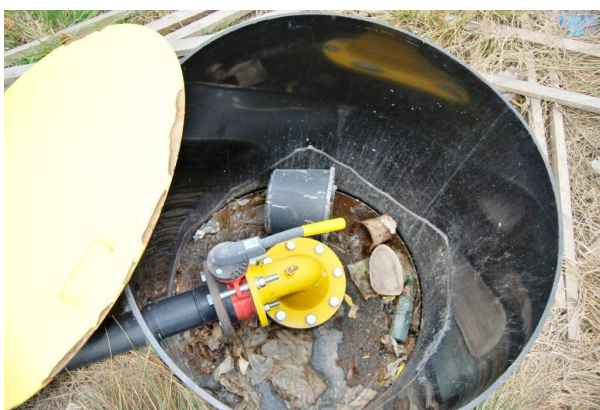
Foto 4.7 Studna č. 107 pro jímání skládkového plynu. (Zdroj: Autor)
