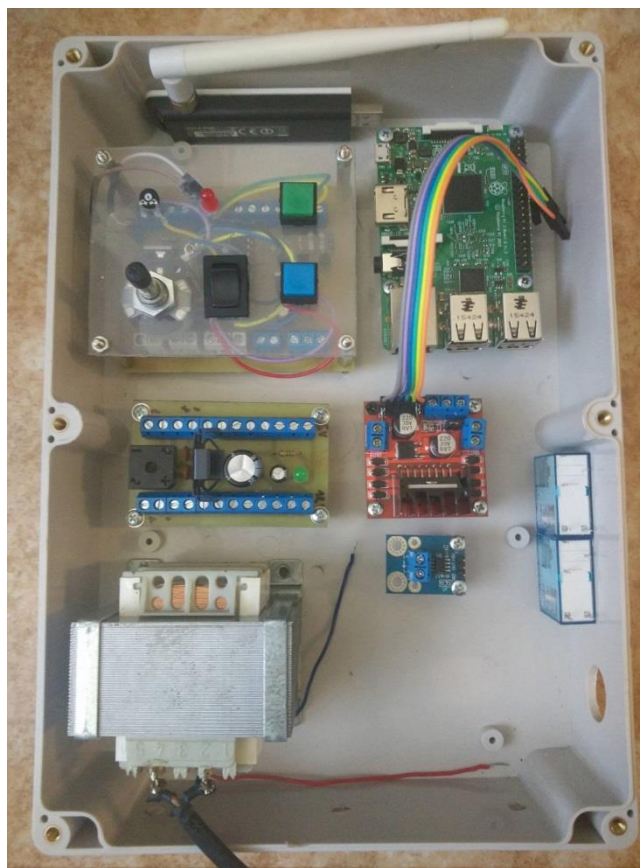
Obr. 36 Transformátor aj s modulmi uloženými v riadiacom boxe
