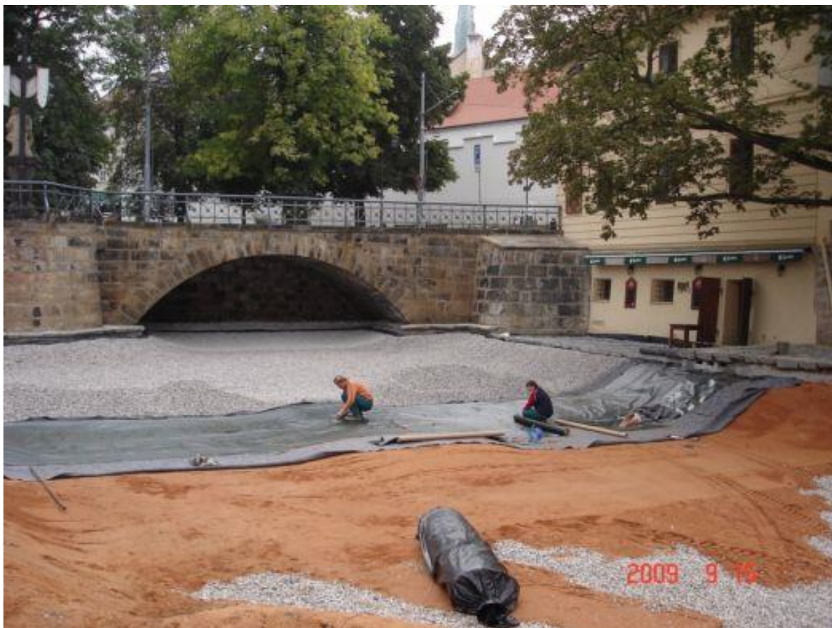
Obrázek 5: Pokládání rybníční folie v oblasti jezírka během revitalizace Mlýnské strouhy (Správa veřejného statku města Plzeň, 2021)
