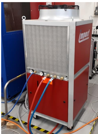
Obr. 18) Chladiaca jednotka vody používaná na pracovisku
