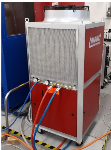
Obr. 18) Chladiaca jednotka vody používaná na pracovisku
