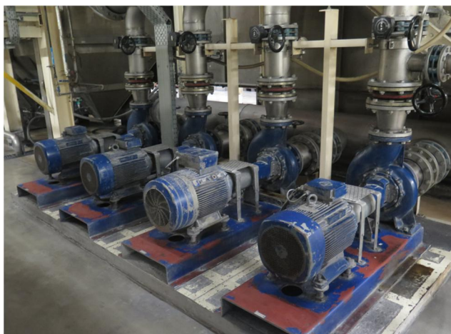
Obrázek číslo 11: čerpadla (zdroj: foto vlastní)
