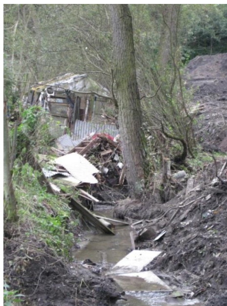
Obr. č. 47 - Maškovský potok mezi drážním mostním objektem a Pražskou ulicí - zdroj (foto autorka DP, 09/2011)
