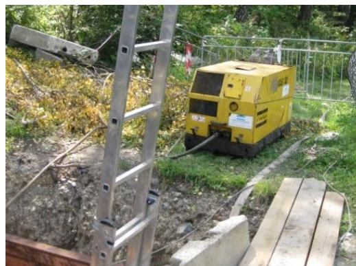
Obr. č. 33 - Kompresor pro sbíječku - zdroj (foto autorka DP, 08/2011)
