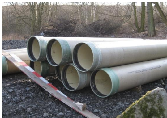
Obr. č. 44 - Sklolaminátové potrubí – zdroj (foto autorka DP, 02/2012)
