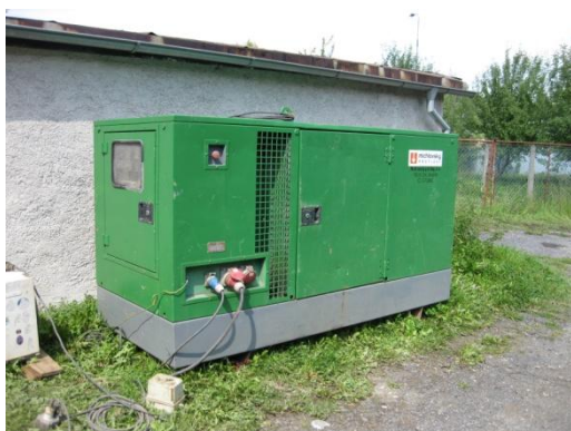
Obr. č. 32 - Nezbytná elektrocentrál - zdroj (foto autorka DP, 08/2011)
