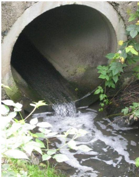
Obr. č. 64 - Napěněná voda pod propustkem - zdroj (foto autorka DP 09/2011)
